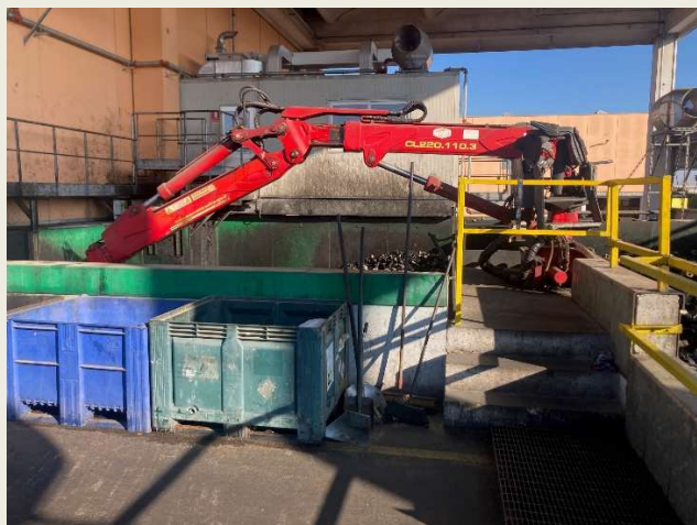
Area G, trattamento filtri olio
